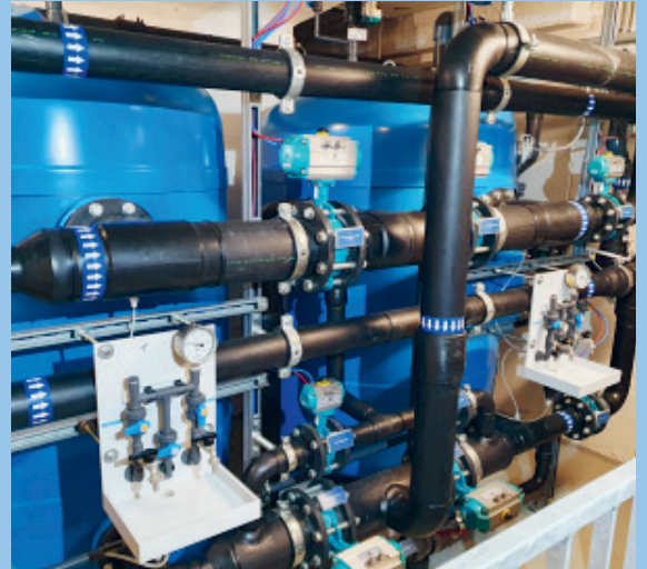
Die moderne Filteranlage hält das Wasser rein.
